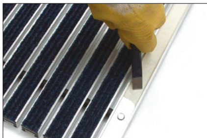
Wichtig: Schmutz, Rips und Klebereste vom Aluprofil entfernen (z. B. mit einem Stechbeitel).
