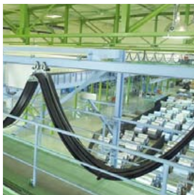
Energie- und Datenübertragung an einem Stahlwerkskran
