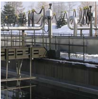
Hauptversorgung eines Längsräumers in einem Klärwerk
