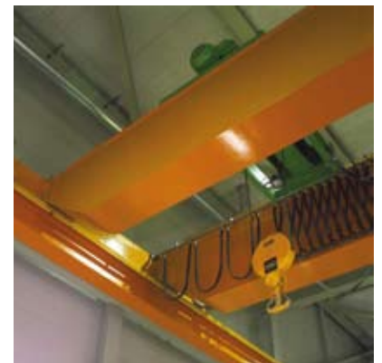
Katzversorgung an einem Brückenkran
