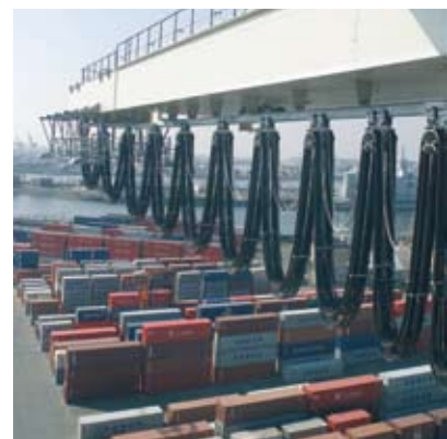
Katzversorgung an einem schnell laufenden STS-Containerkran
