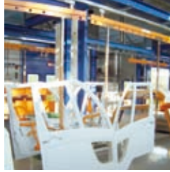
Handhängebahn zum manuellen Transport von Fahrzeugkomponenten
