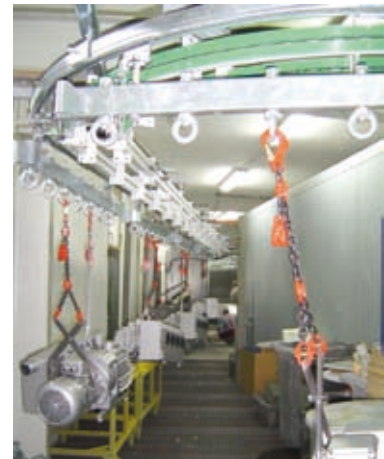
Handhängebahn in Verbindung mit einem Schleppkreisförderer zum Transport von Vakuumpumpen durch einen Trocknungssofen
