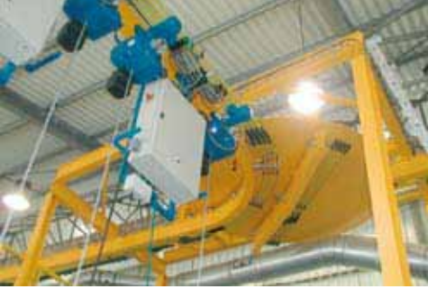
SinglePowerLine 0812 in einer Galvanik-Anlage mit Überfahrelementen an einer Drehweiche und Doppel-Stromabnehmer
