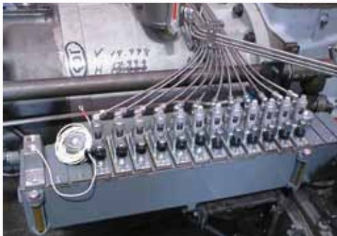
Schmierölapparat und Pumpensystem
